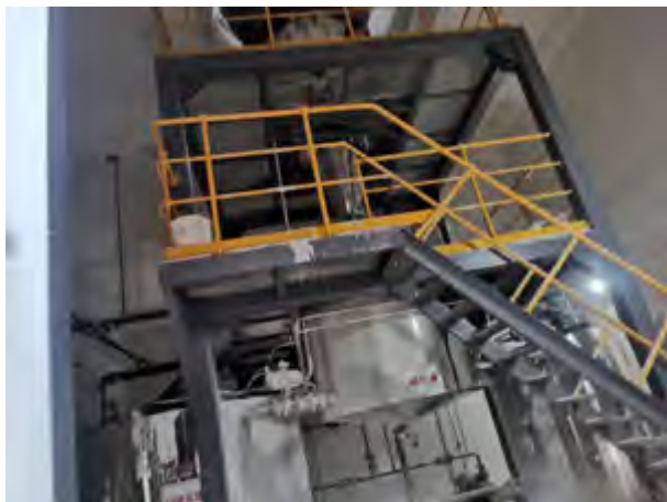
石灰制浆系统
