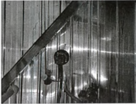
垃圾焚烧炉进口 (◎ 1#)
