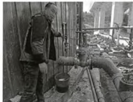
渗滤液处理站进口 (★2#)
