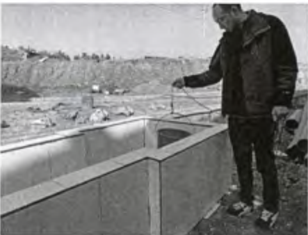
渗滤液处理站出口 (★3#)
