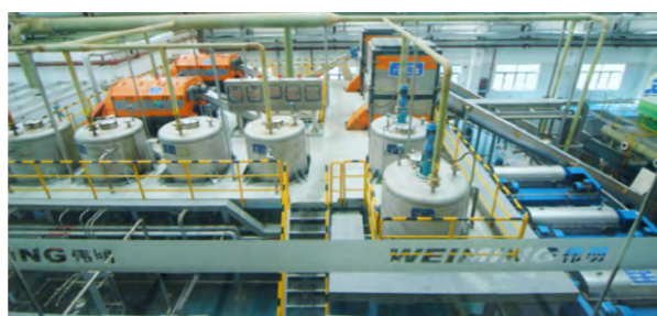
餐厨项目车间
