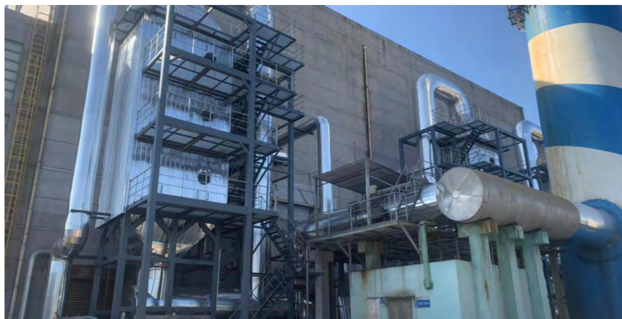
昆山项目炉外脱硝设备
